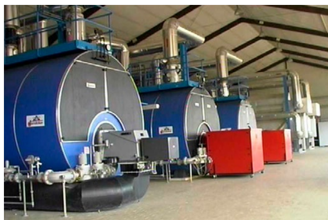
Rys. 6. Nisko- i wysokotemperaturowe kotły w ciepłowni geotermalnej w Pyrzycach
