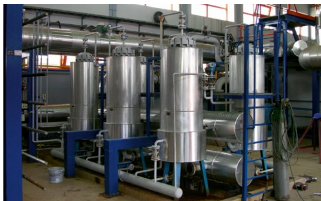
Rys. 15. Zespoły workowych filtrów geotermalnych
