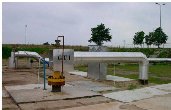
Rys. 14. Głowice otworów: zatłaczającego i wydobywczego GT-1 i GT-2
