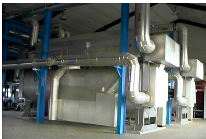
Rys. 7. Absorpcyjne pompy ciepła w ciepłowni geotermalnej w Pyrzycach
