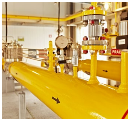
Fot. 5. Elementy jednej ze stacji gazowych
