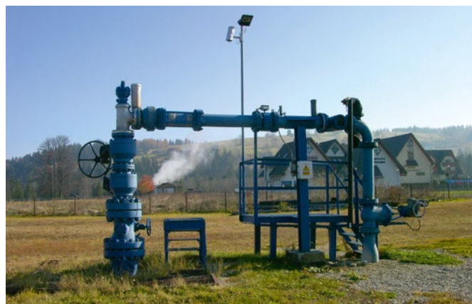
Rys. 9. Ujęcie geotermalne Bańska PGP-1 w ciepłowni w Bańskiej Niżnej
